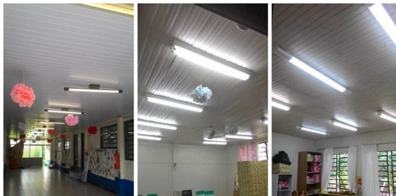
Figura 5 – Iluminação após a realização do trabalho Fonte: Arquivo dos autores
